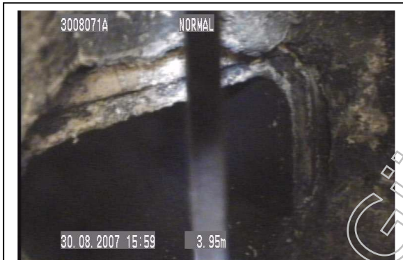
Nr. 3 Beschädigung des Innenrohres beim Abgasrohranschluss 3,95 m von dem oberen Reinigungsverschluss nach unten aus gesehen
