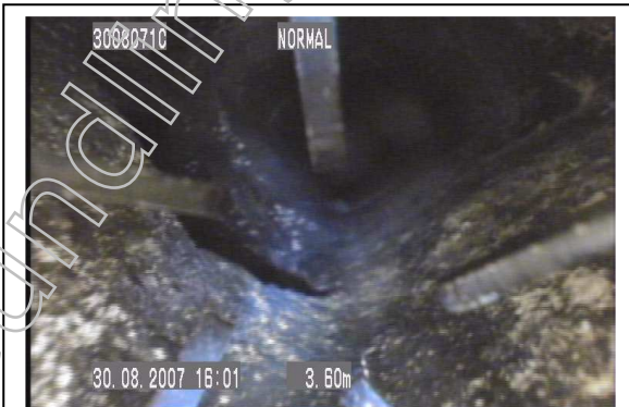
Nr. 3 Beschädigung des Innenrohres beim Abgasrohranschluss 3,60 m von dem oberen Reinigungsverschluss nach unten aus gesehen
