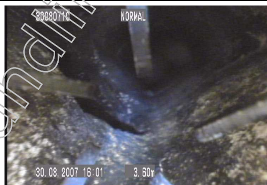
Nr. 3 Beschädigung des Innenrohres beim Abgasrohranschluss 3,60 m von dem oberen Reinigungsverschluss nach unten aus gesehen
