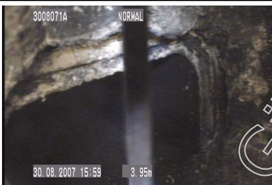
Nr. 3 Beschädigung des Innenrohres beim Abgasrohranschluss 3,95 m von dem oberen Reinigungsverschluss nach unten aus gesehen
