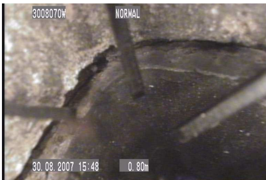
Nr. 1 Beschädigung Innenrohr: 0,80 m von dem oberen Reinigungsverschluss nach oben aus gesehen
